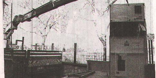
Makine ve Malzeme İktisadi Dairesi Başkanlığı, gelişmiş bir güç destek sistemi de inşa etti. Yeni sistem sayesinde, içme suyu tesisine gelen enerjiyi
